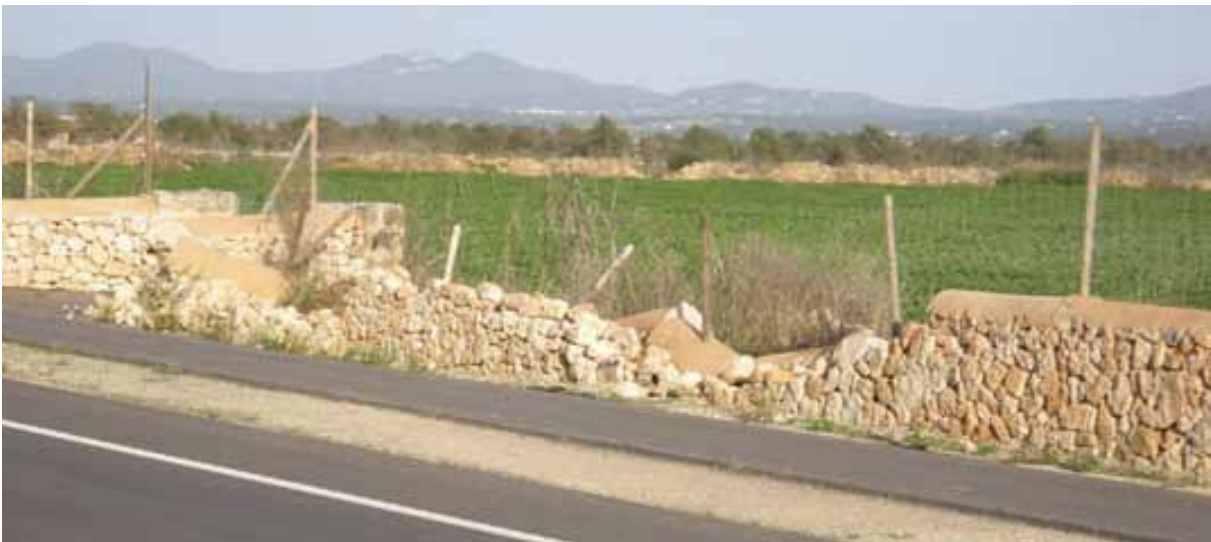
Figura 9. A Son Catlar aquesta paret va ser tomada per un accident. El resultat és molt aparatos en aparença, però els danys sobre els vehicles són mínims en absorbir l'esbaldrec l'energia.
