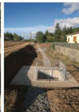
9. POUS DE VENTILACIÓ 7 I 6
