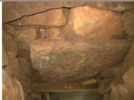
3. TRENCAMENT LOCAL D'UNA DE LES LLOSES PLANES DE COBERTURA
