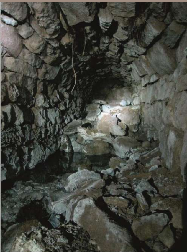
1. ENFONSAMENT LOCAL D'UN TRAM DE LA MINA DES DE L'INTERIOR
