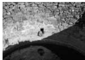
Cisterna construïda localitzada en l'estudi d'impacte sobre el patrimoni del Parc Eòlic de Mudèfer, vista de l'interior.
